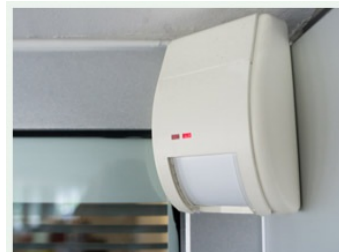
Alarme anti intrusion
